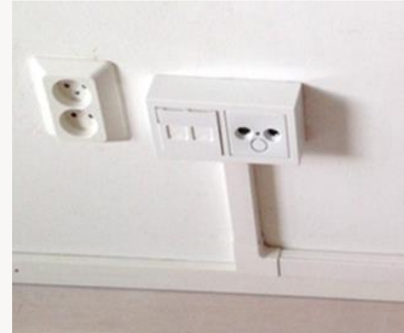
Pinta-asennettu antenni- ja tietoliikennepiste
