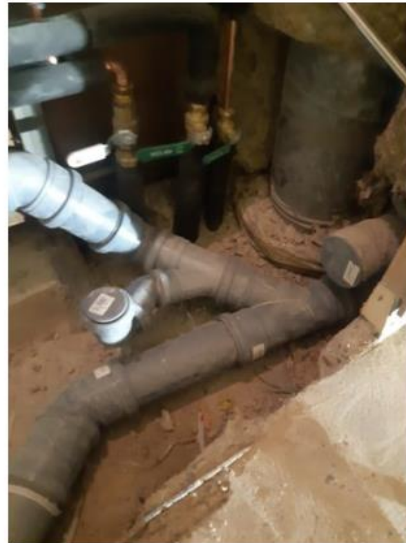
Kuva 6. Valvontamuistiosta. Tekniikkakuilu on umpeenvalettu. IV-kanavat ovat peltisiä.
