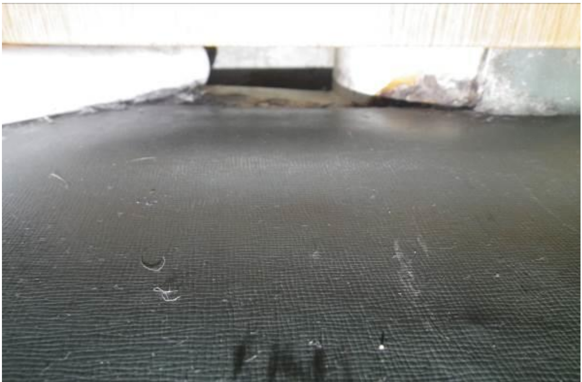
E52 kylpyhuone, matossa on reikiä
