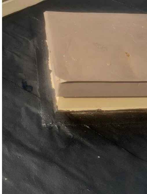
Kuva 24 Kattoluukun reunassa on pinnoitetta.
