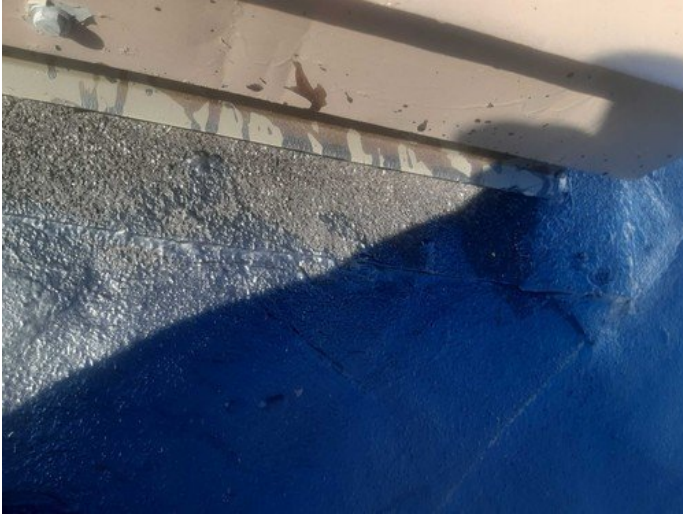
Kuva 23 Kattoluukun reunassa ei pinnoitetta.
