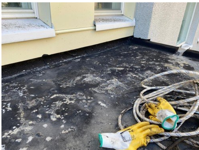
Kuva 21 B portaan sisäänkäynnin lipan pinnoite.
