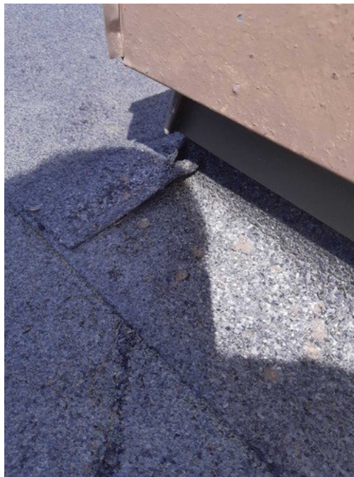
Kuva 6 Kattoluukun huopavahvikkeet irvistävät.
