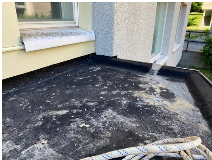
Kuva 20 B portaan sisäänkäynnin lipan pinnoite.
