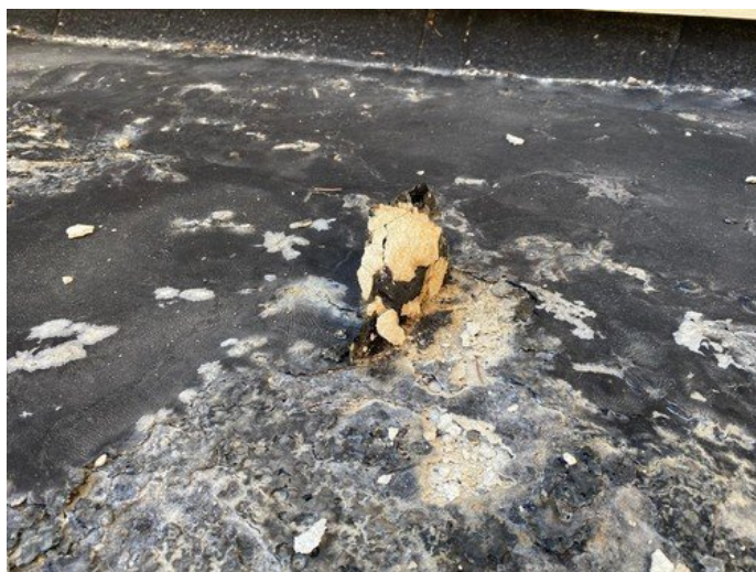
Kuva 22 B portaan sisäänkäynnin lipan pinnoite.
