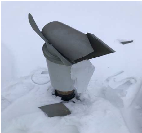
Kuva 3. Tuuletusviemäriin jäätymissuoja hajonnut, Suositellaan uusittavan (Huolto)
